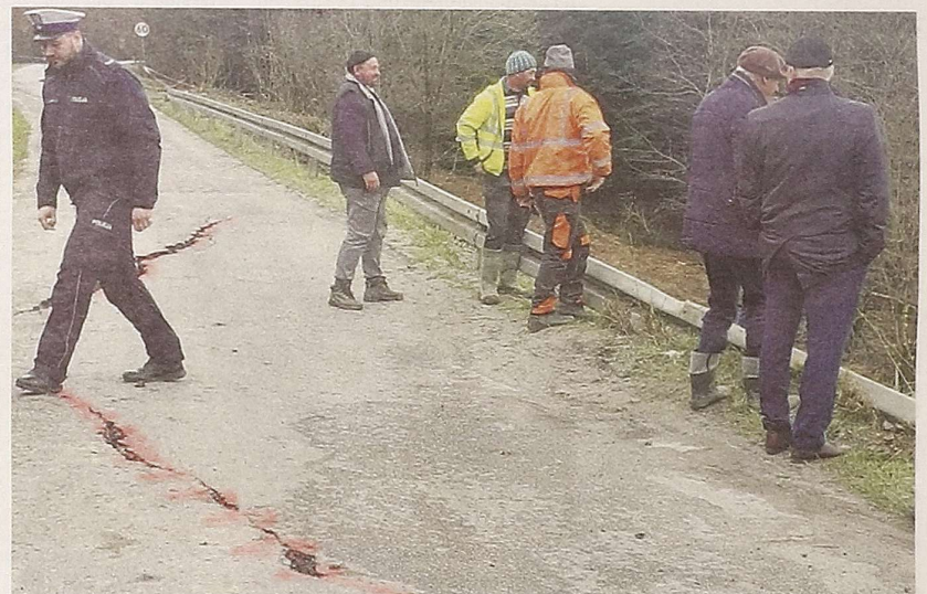
Fragment zamkniętej drogi. FOT. ARCHIWUM STAROSTWA POWIATOWEGO W USTRZYKACH DOLNYCH
